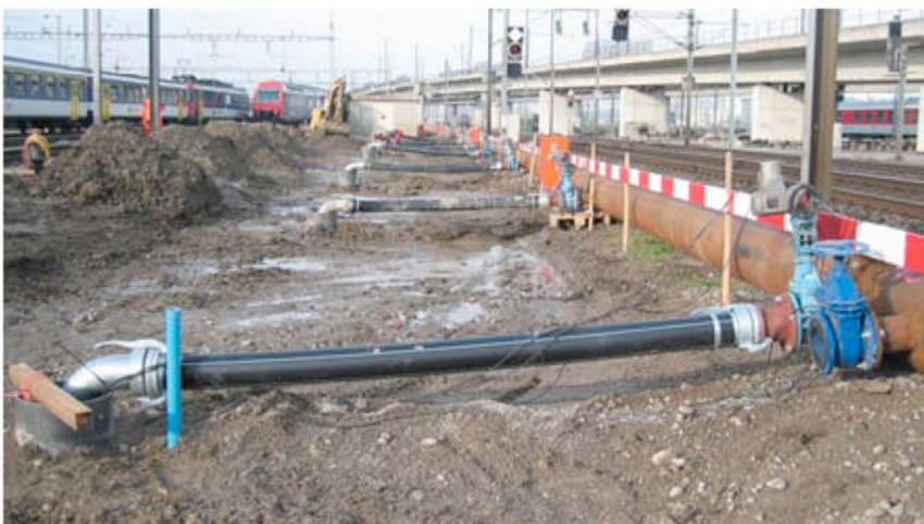
Abb. 5 Versickerungsbrunnen mit automatischen Schiebern im Bahnbereich
